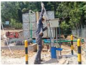
Instalasi MMO Anode
