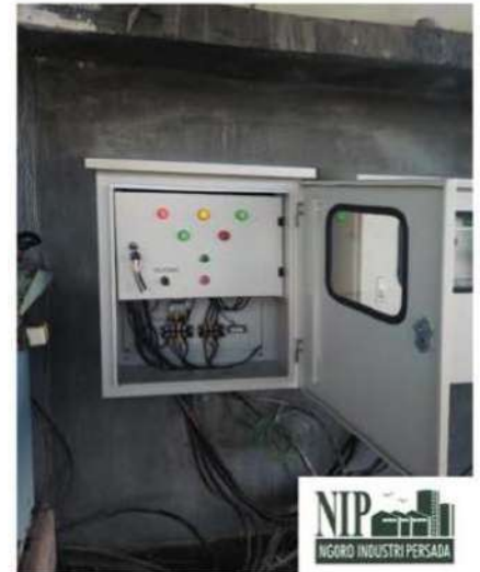
Panel Pompa untuk PT. Nggoro Industrial Park
