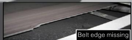
Belt edge failure
